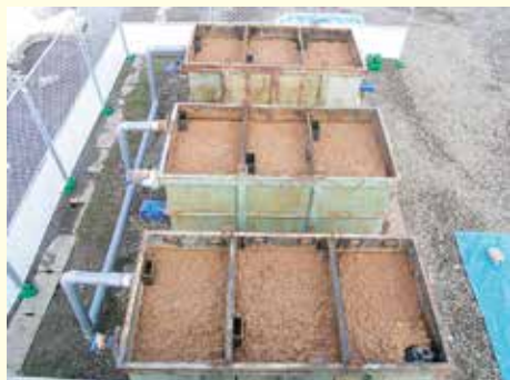
灯油流出事故現場油水分離槽
