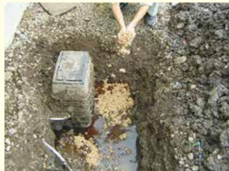
タンクからの灯油流出
