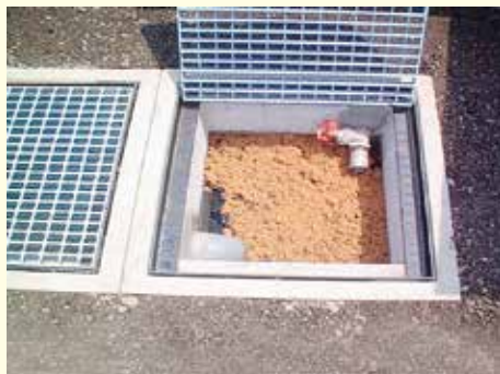
舗装プラント油水分離槽
